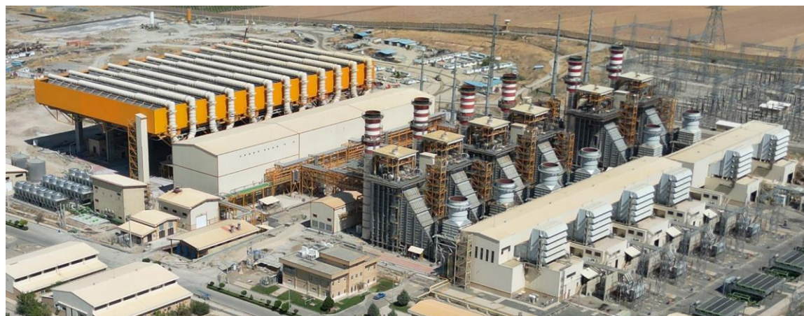
نیروگاه سیکل ترکیبی ارومیه
